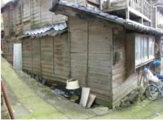
危険空家【解体前】
