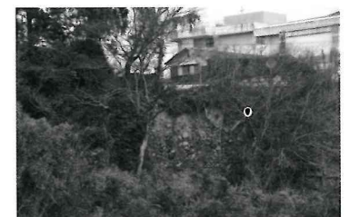
改善センター南側道路・平田川岸壁崩落状況
