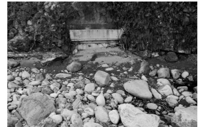
壊れた頭首工
