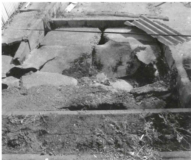
銀座地区の排水路崩壊状況
