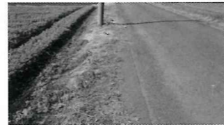
両側に側溝がない
