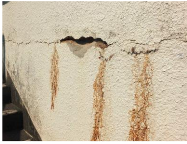
校舎：外壁のひび割れ
