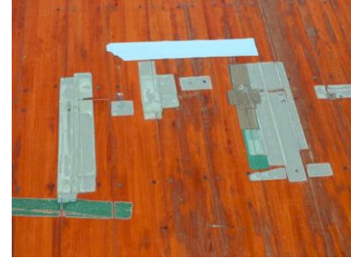
屋内運動場：床の劣化
