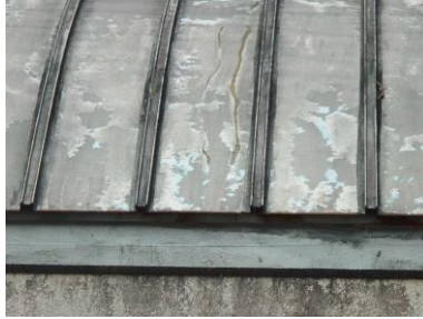
屋内運動場：屋根の劣化
