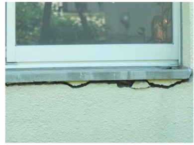
校舎：外壁のひび割れ
