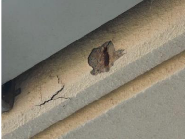
校舎：錆による爆裂
