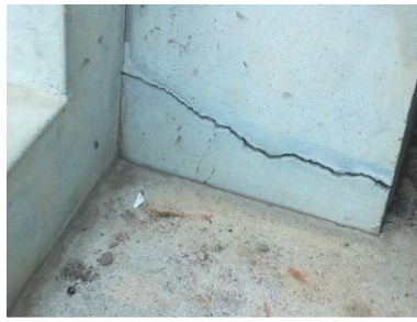
校舎：外壁のひび割れ
