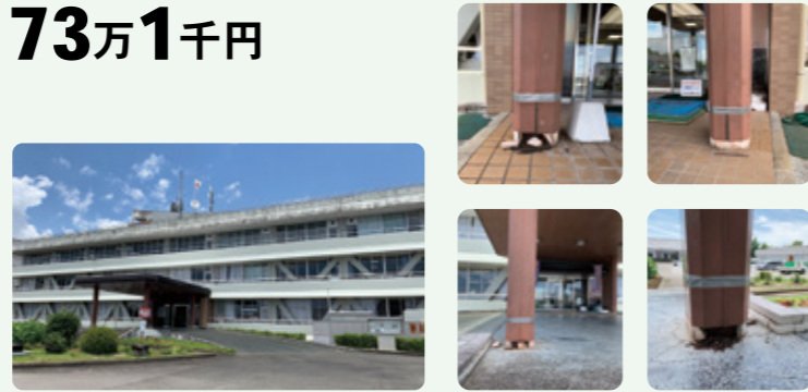
① 本館・別館の外壁工事 ② 本館南側玄関前の柱4本とも腐食している
