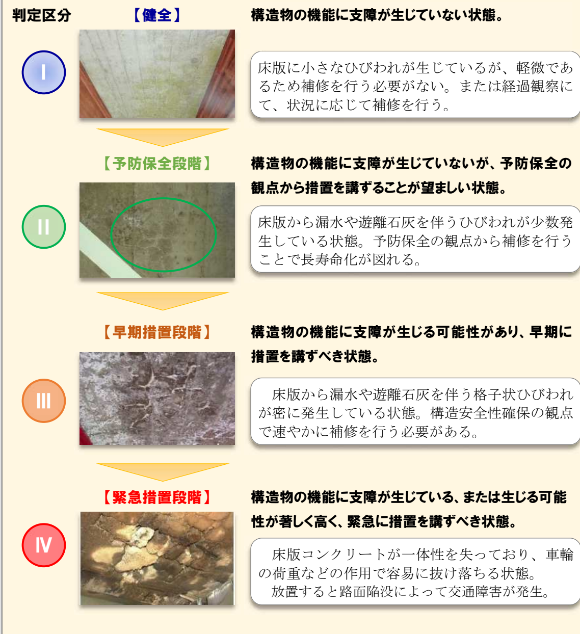
図 15 橋の健全度の事例
